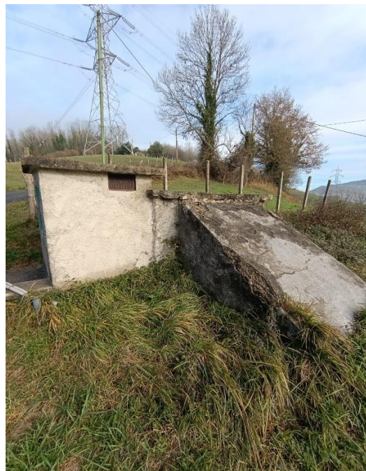
Ilustración 4. Losa superior a demoler y rehacer en acceso
