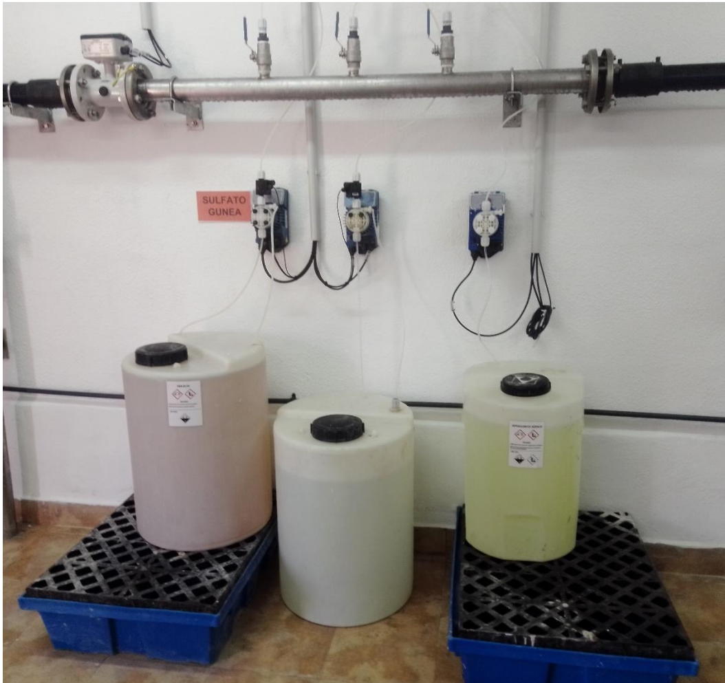
Ilustración 14. Reactivos con cubeto, deposito, bomba y picaje con válvula en la conducción
