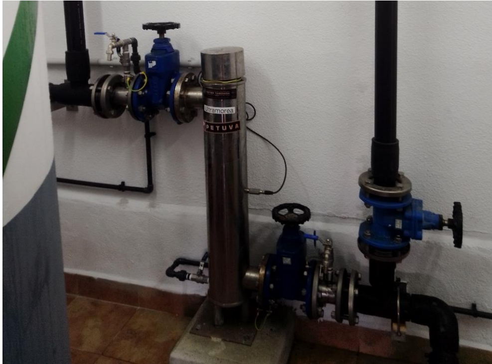
Ilustración 8. Sistema ultravioleta con las válvulas del by-pass y los picajes de 1”
