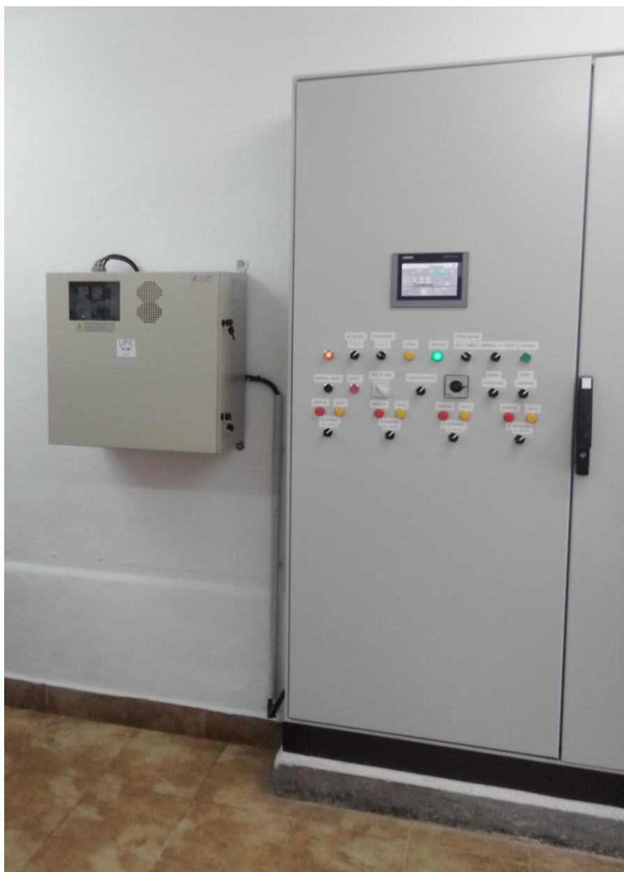
Ilustración 15. Cuadro principal y cuadro del UPS separado
