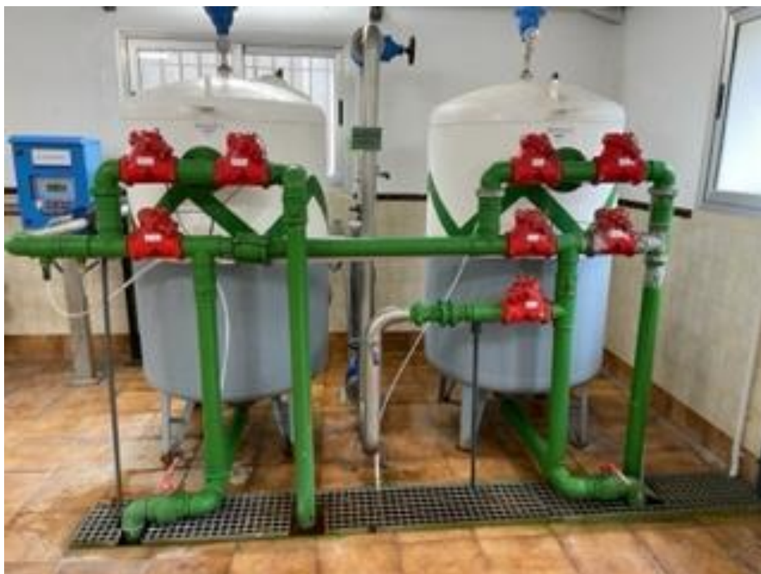
Ilustración 7. Sistema de omnifiltración OFSY-48 con tuberías de interconexión y válvulas
