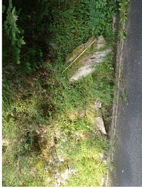
DETALLE DE BLOQUE DESPRENDIDO JUNTO AL PUNTO DE OBSERVACION ④
