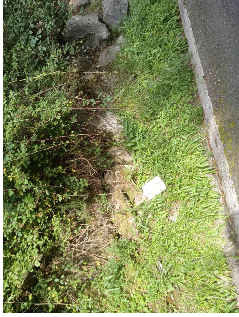
DETALLE DE DESPRENDIMIENTO DE ROCA DE PEQUEÑAS DIMENSIONES EN EL PUNTO DE OBSERVACION ⑦
