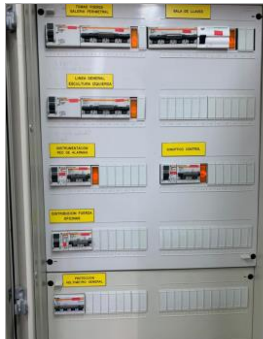
Cuadro de la caseta de control de presa en coronación
