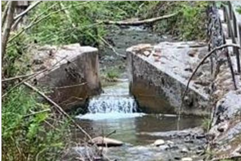
Vertedero tipo Parshall
