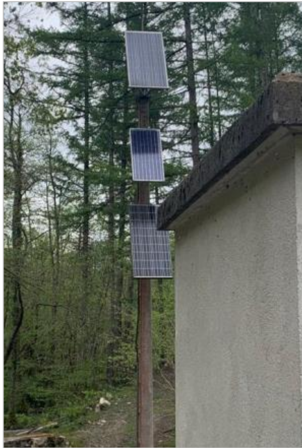
Paneles solares sobre poste de hormigón
