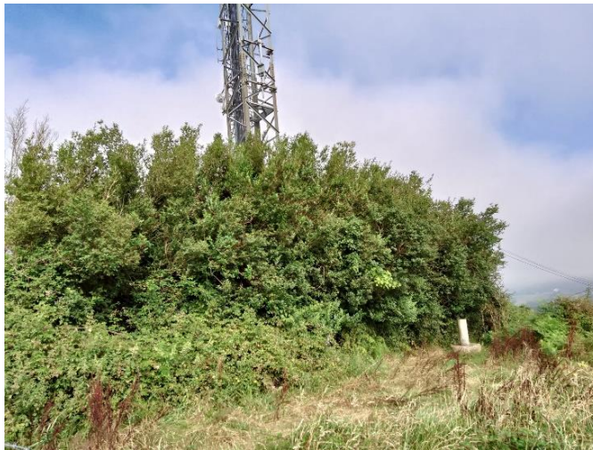
Ilustración 3. Antena de telecomunicaciones.
