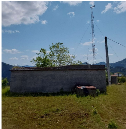
6 - Imagen de la cubierta inferior (zona verde), arqueta y cubierta superior (zona de llaves)
