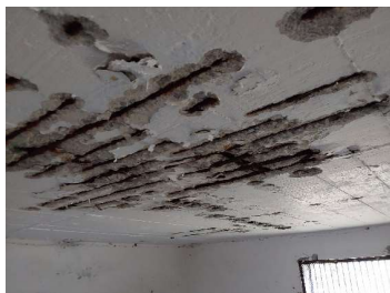
5 - Imagen del estado de la cubierta por el interior (cámara de llaves zona alta)
