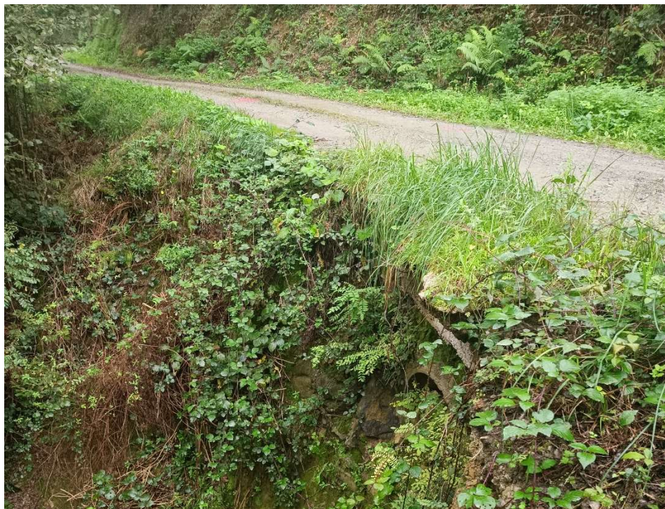
Ilustración 3. Deslizamiento nº1. Se puede observar la existencia de un caño de hormigón de 500mm de diámetro.
