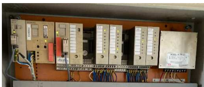
Ilustración 4. Armario depósito Danona.
