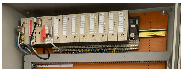
Ilustración 6. Armario depósito Zestoa.
