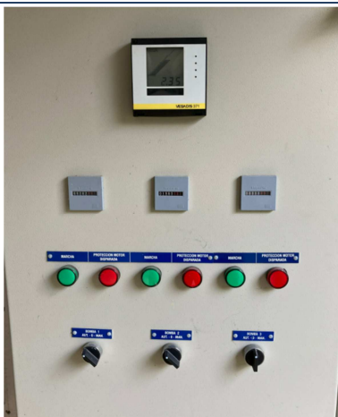
Ilustración 19. Armario bombeo Elcano.
