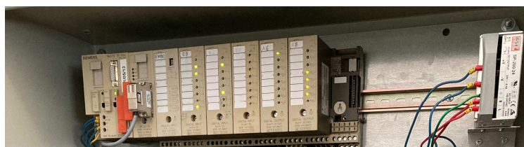
Ilustración 9. Armario depósito Sansinenea.
