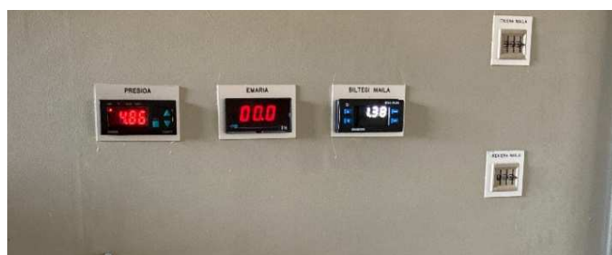
Ilustración 3. Tapa armario Danona.
