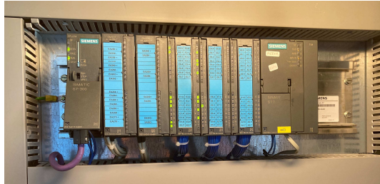
Ilustración 28. Armario bombeo Azpeitia.
