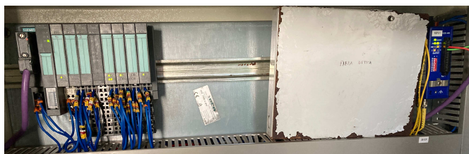
Ilustración 8. Armario depósito Aizarna.
