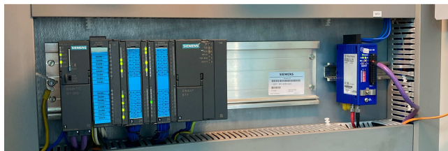
Ilustración 7. Armario bombeo Aizarna.
